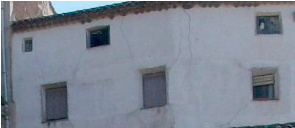
Viviendas en el pueblo de Montón, al norte del epicentro de 1953, dentro de la isosista de intensidad VII; se pueden ver las deformaciones a cortante en aspa o en "x" típicas de este fenómeno con movimiento horizontal, la direccionalidad indica un movimiento norte-sur y han vuelto a aflorar las deformaciones décadas después, incluso tras haberlas lucido y "maquillado", algo que aparece de forma recurrente en los pueblos afectados de la zona como Used, Torralba de los Frailes, Manchones, Murero, Atea, Acered, Gallocanta o en la misma Daroca.
