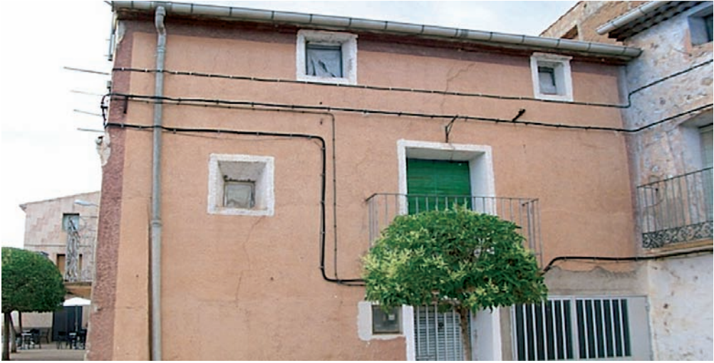
La zona más afectada aunque arreglada Y "maquillada" se encuentra muy cerca de la casa de Esperanza Pardos (al fondo) todos los edificios muestran las huellas de aquel evento sísmico, sobre todo en los ángulos.
