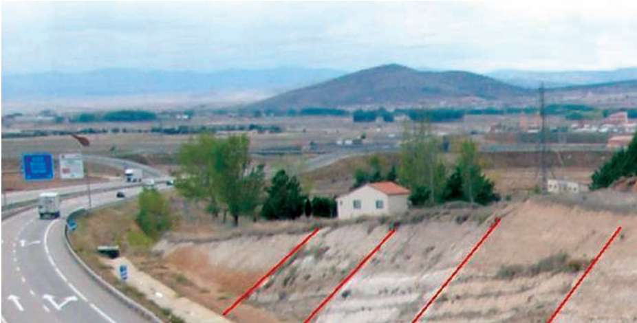
En La Autovía Mudéjar, a la Altura de Calamocha, se puede apreciar el movimiento de las fallas de una manera extremadamente gráfica.
