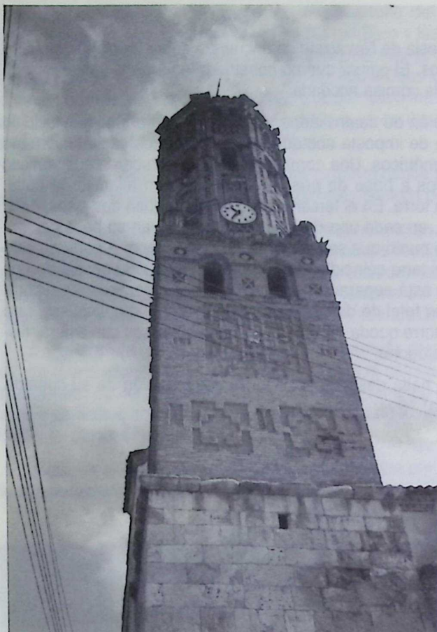
Cara Sur de la torre donde se aprecia el deterioro de la cornisa de piedra de su primer cuerpo y la pérdida de ladrillos decorativos.
