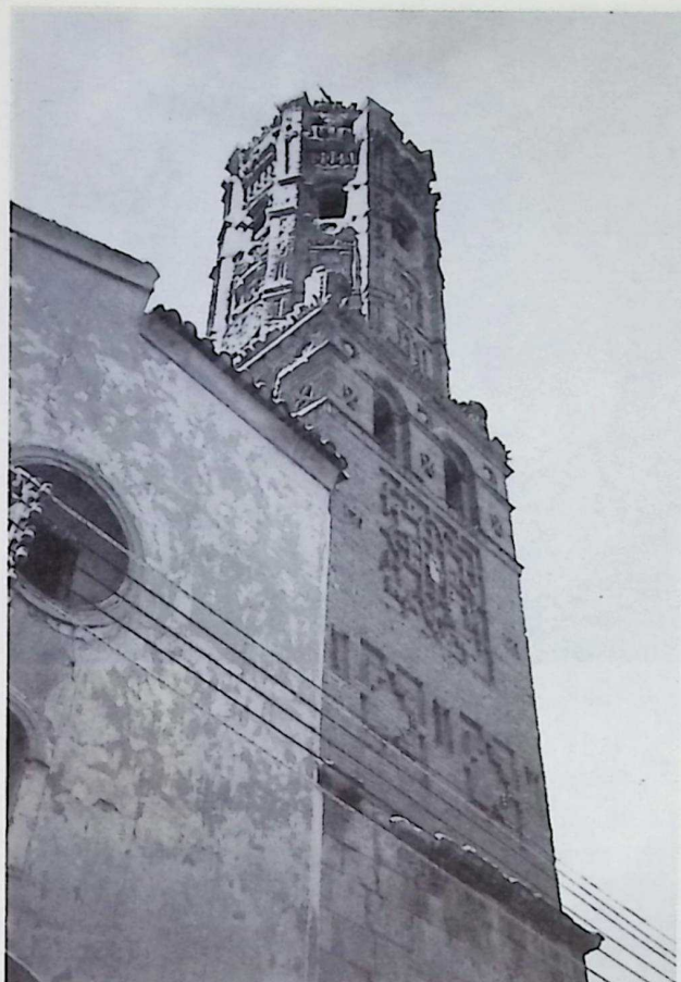
Detalle del deterioro del tercer cuerpo de la torre.
