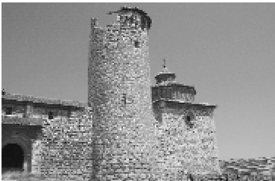
Torre medieval o Torretón que precisa restauración.
