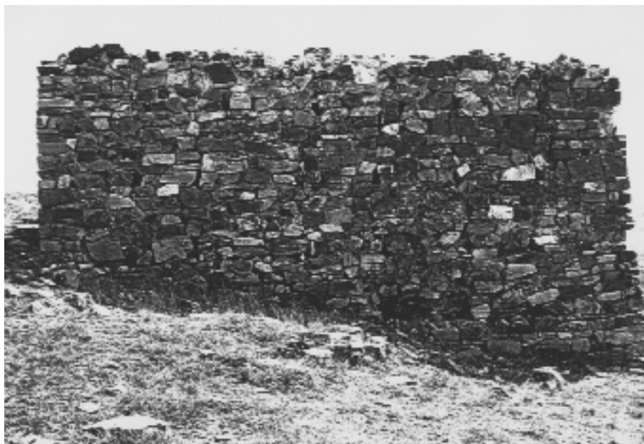
Foto 4. Detalle del muro de 8,5 m que se mantiene en pie del torreón B. El desnivel del terreno entre los extremos del muro es de 2,2 m.
