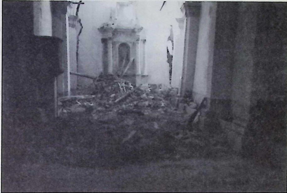
Interior de la ermita de Santiago, totalmente hundida. Actualmente el pueblo ha requerido al arzobispado para su reparación. (Foto A. Alcañiz)
