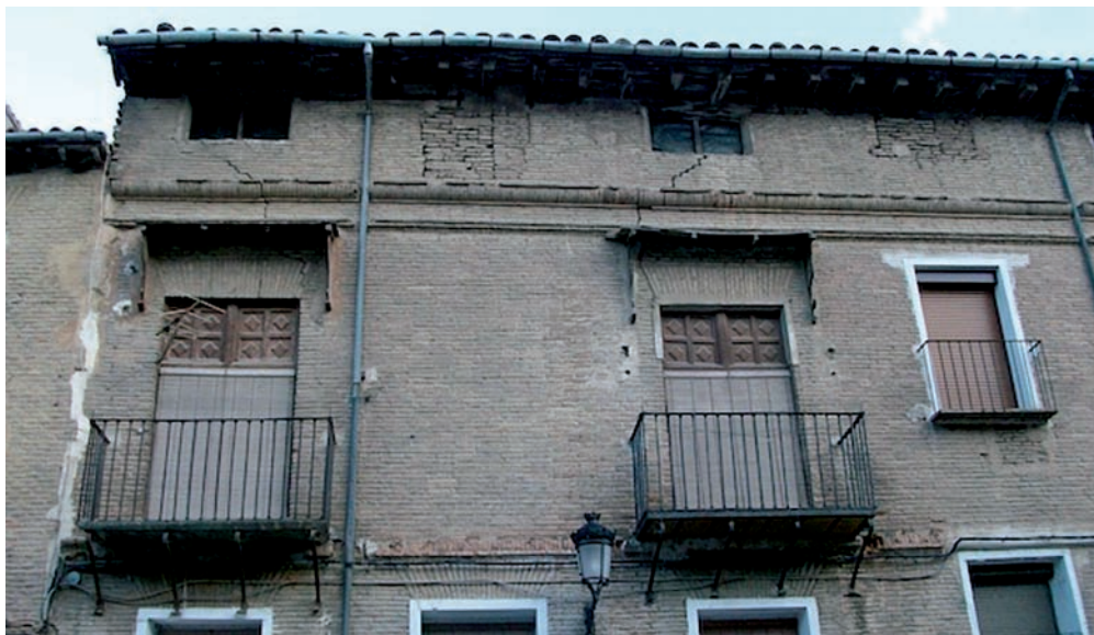
Algunas de las edificaciones de Daroca muestran también daños a cortante que se han ido revelando por el abandono y el deterioro posterior.
