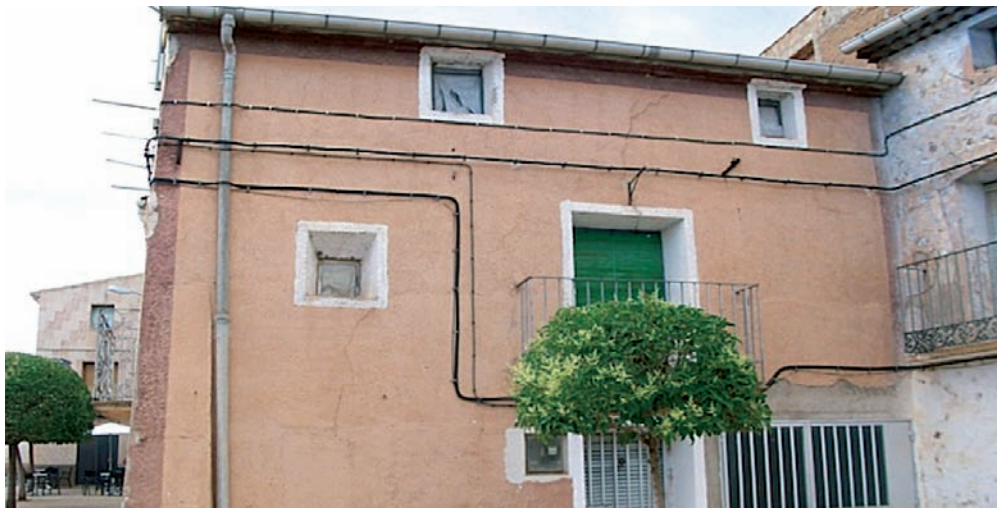
La zona más afectada aunque arreglada Y "maquillada" se encuentra muy cerca de la casa de Esperanza Pardos (al fondo) todos los edificios muestran las huellas de aquel evento sísmico, sobre todo en los ángulos.
