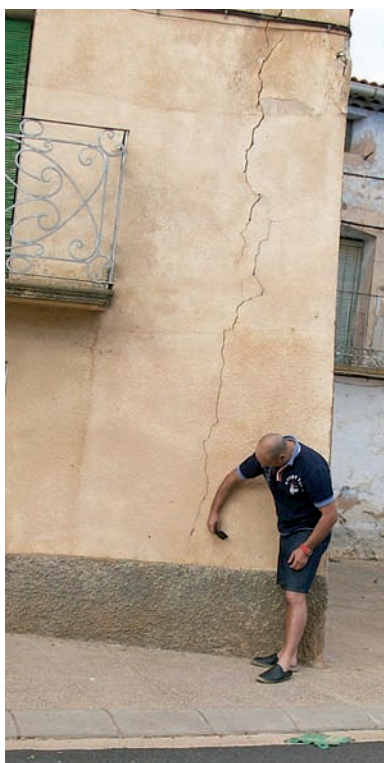
Algunas de las grietas han vuelto a aflorar después de haber sido lucidas en varias épocas.
